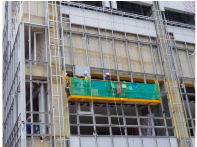
タワーマンションで使われているロングスパンゴンドラ(韓国釜山にて)
