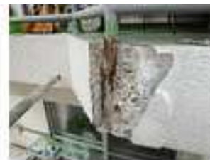
手摺り支柱の腐食
