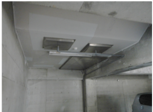
漏水が多発する駐車場の天井
