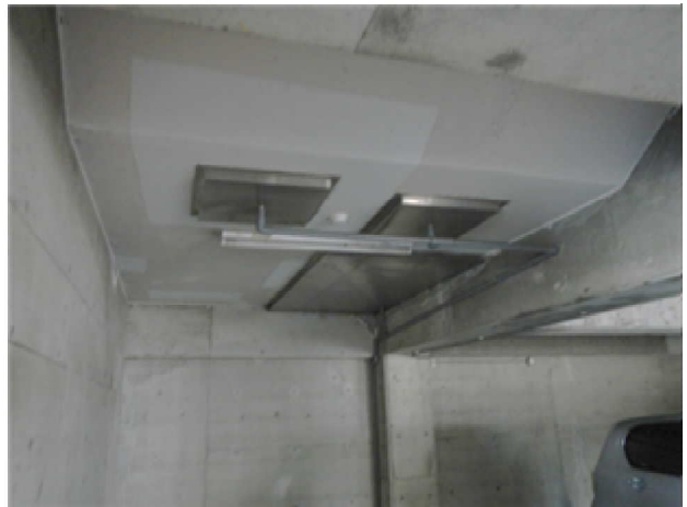
漏水が多発する駐車場の天井
