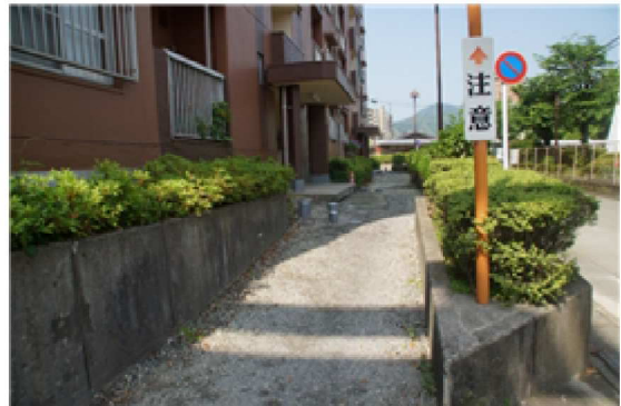
Cマンションのアプローチの舗装沈下(通路のVP管露出部が沈下している。舗装は応急手当て砂利敷としている)
