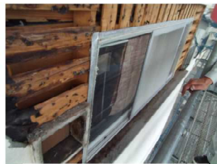
不適切材料で不法に増築されたバルコニーの部屋
