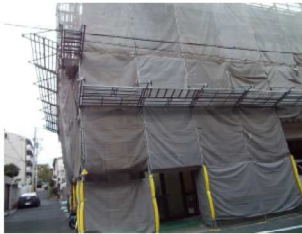
敷地からはみ出した足場と朝顔（道路専有が必要）
