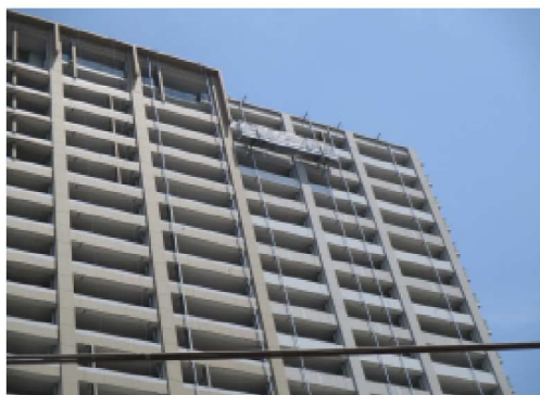
レール付きのゴンドラ足場
