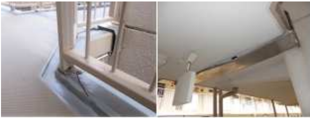
地震によるEXP. Jの損傷
