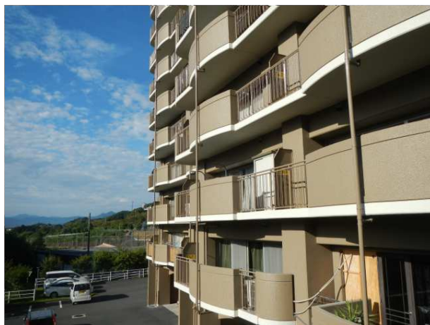
ベランダの中央に増設された樋へ排水
