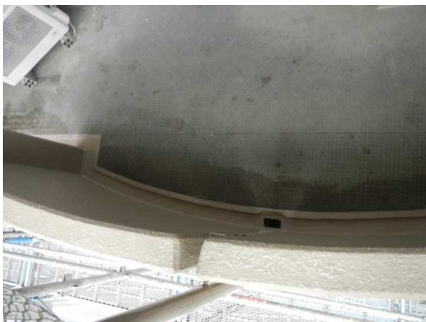
ベランダ溝の中央に増設された排水金物
