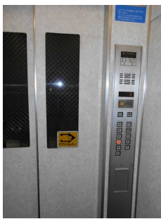
改修前（カゴ内）
