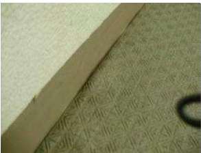
床からの湿気が床材を浮かす
