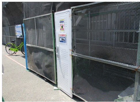
1階の足場出入口と養生金網
