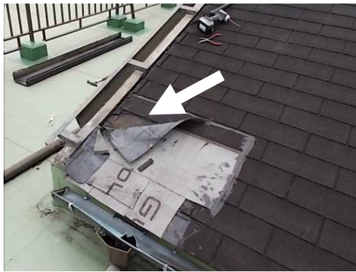
写真3 傾斜屋根の浸入箇所 (矢印部分)
