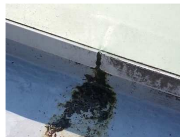
写真1 端部からの水のしみ出し
