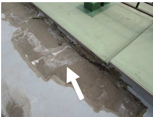
写真4 防水層の下から流れ出る水 (矢印部分)
