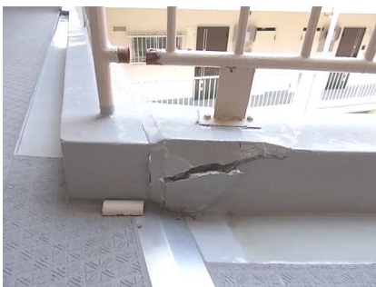
2018年 大阪北部地震による損傷
