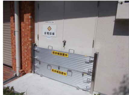
電気室入口ー設置前と設置後
