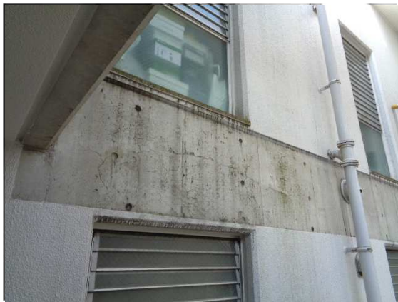
工事前コンクリート打放面の劣化と汚染
