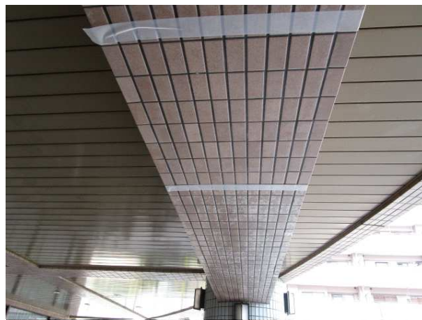
スポンジ状の研磨材を用いた施工例 (奥の方が施工前、手前が施工後)
