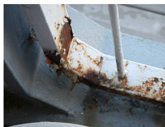
腐食が進む手すり
