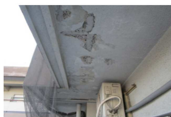
コンクリートが剥落した天井
