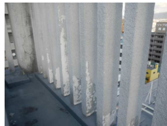
塗装が剥がれ落ちる塔屋の格子状の壁
