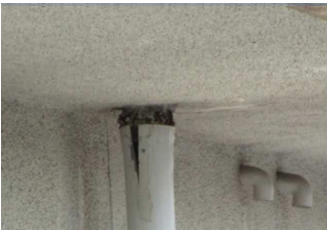
樋が割れ漏水する
