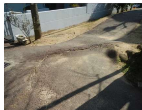
木の根による舗装の隆起
