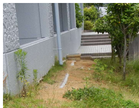
土砂が流れ埋設管が露出
