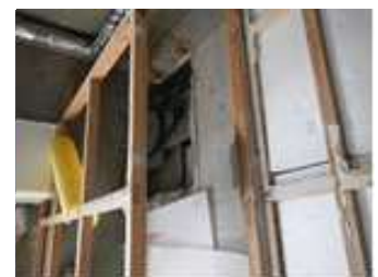
防火区画壁に 放置されたままの開口
