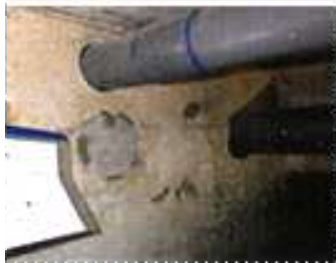
補強筋のない配管貫通部
