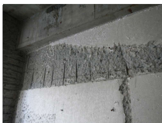
耐震壁コンクリート断面欠損
