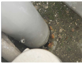
腐食し原型を留めていない排水金物
