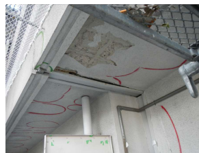
漏水や曝露が多発する EXP. J 金物周辺
