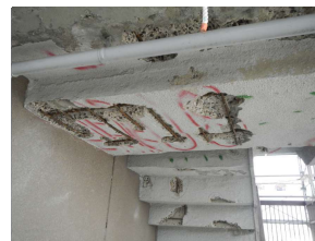
屋外階段天井の曝裂
