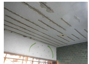
廊下天井の曝裂
