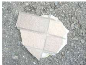
左写真裏面(タイル表面) 目地の交点に樹脂注入跡
