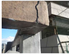
落下の危険があるコンクリート手すり
