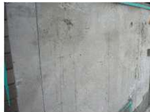
タイル剥離面
