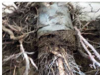
木の根がぎっしり詰まった排水管
