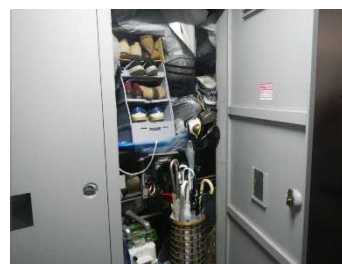
物入れ代わりになっている メーターボックス
