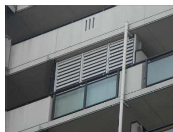
バルコニーを塞ぐ鋼製スクリーン
