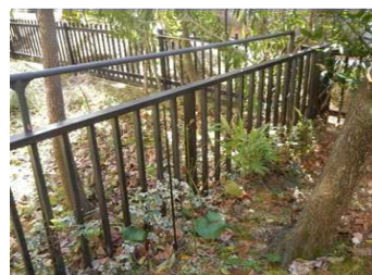
庭の土に埋もれ、腐食が進む柵
