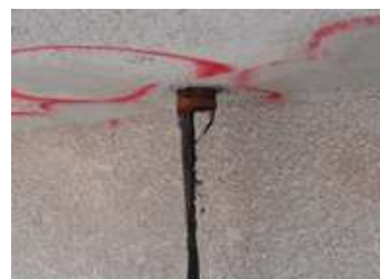
樋を撤去した後に確認された洗濯排水のヘドロ
