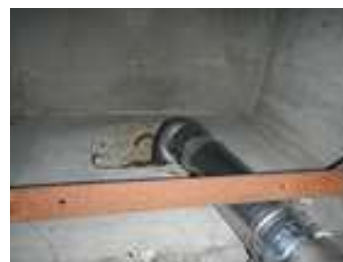
給湯器のダクトを通すために 鉄筋を切断し穴が開けられた大梁
