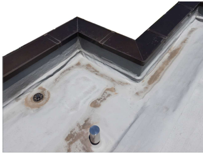
ドレイン近くの脱気筒と溝内の水溜り
