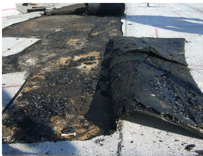
密着不良のアスファルトルーフィング
